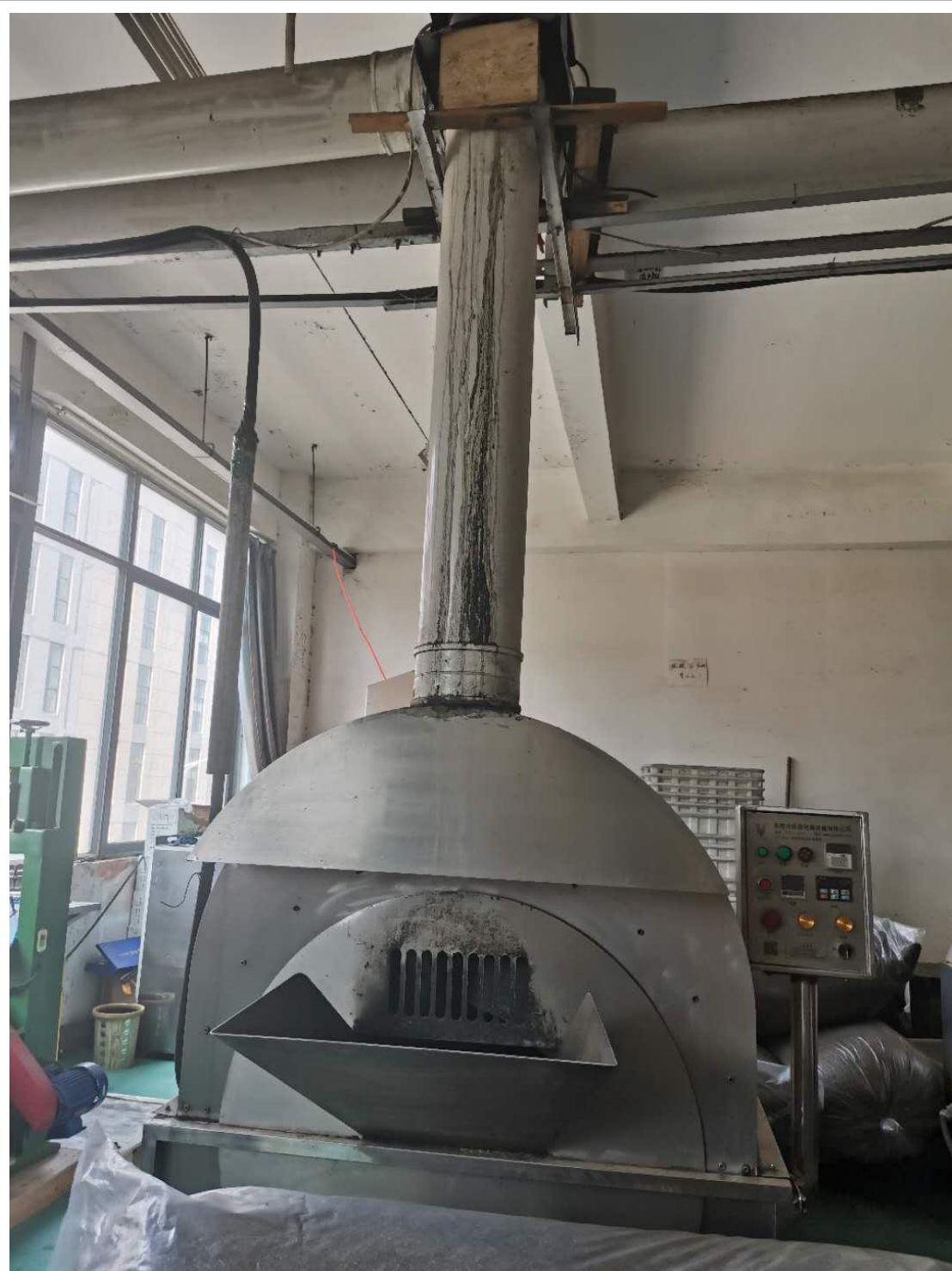
烘干废气抽气管道
