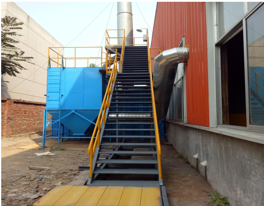
图 3-5 布袋除尘器和采样平台
