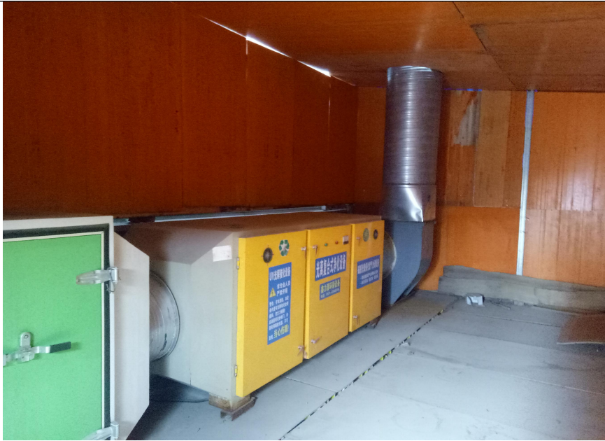
图 3-4 过滤棉过滤和 UV 光氧化催化装置
