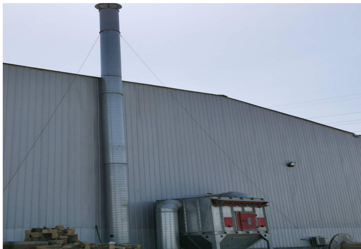
废砖、坯破碎：袋式除尘器+ 15m 高排气筒
