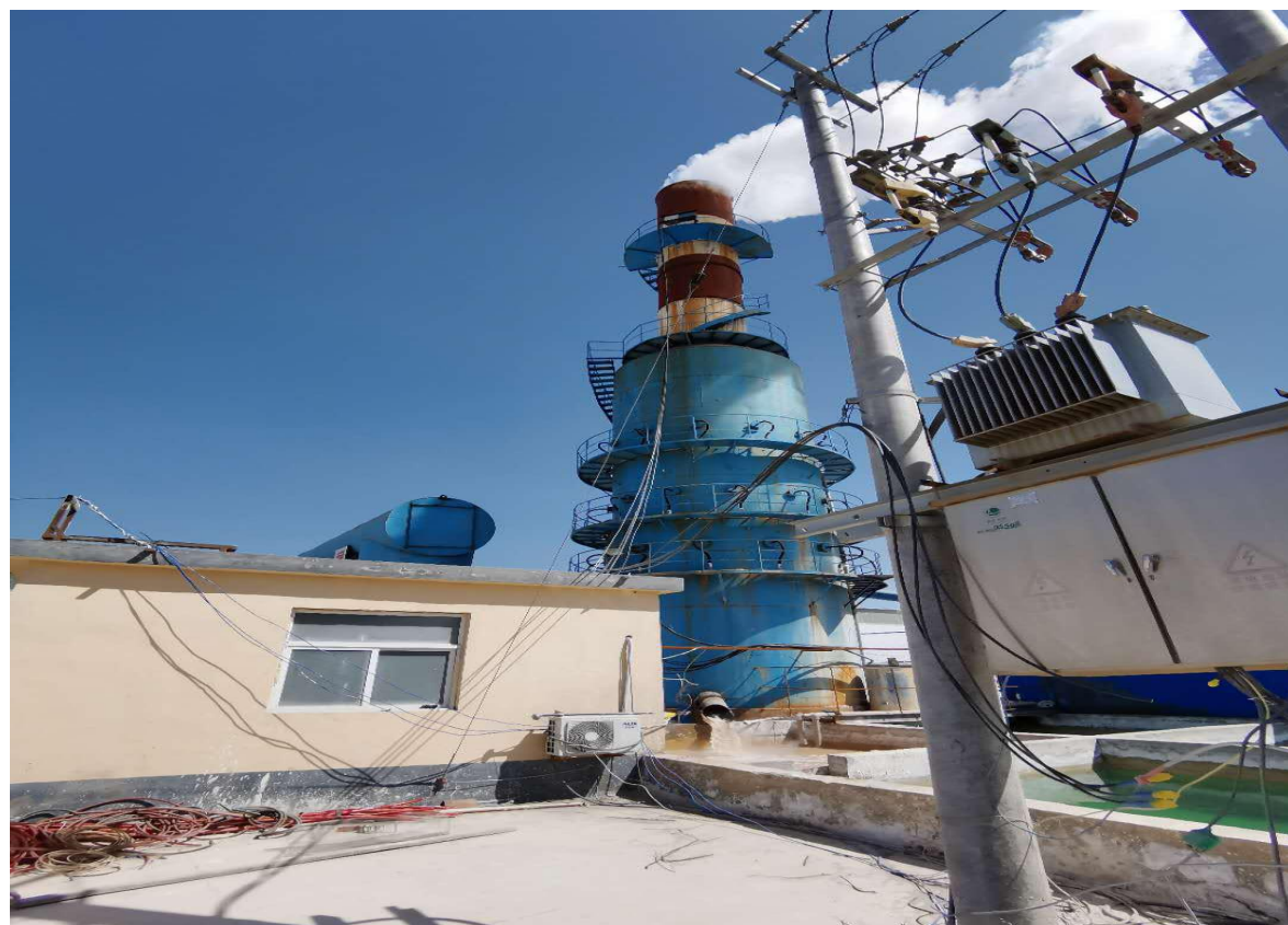
煤气净化及窑炉尾气：煤气燃用前除尘脱硫+燃烧时SNCR，经 15m 高排气筒排放
