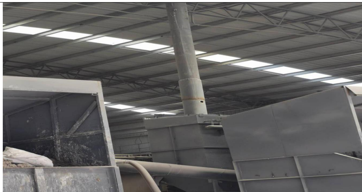
配料：袋式除尘器+1 根 15m 高排气筒
