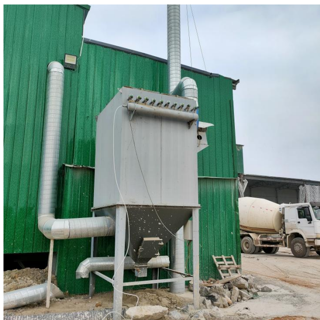
布袋除尘器+15m 排气筒
