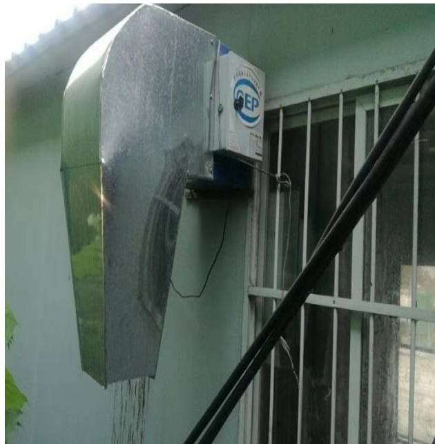
油烟净化器+排气筒
