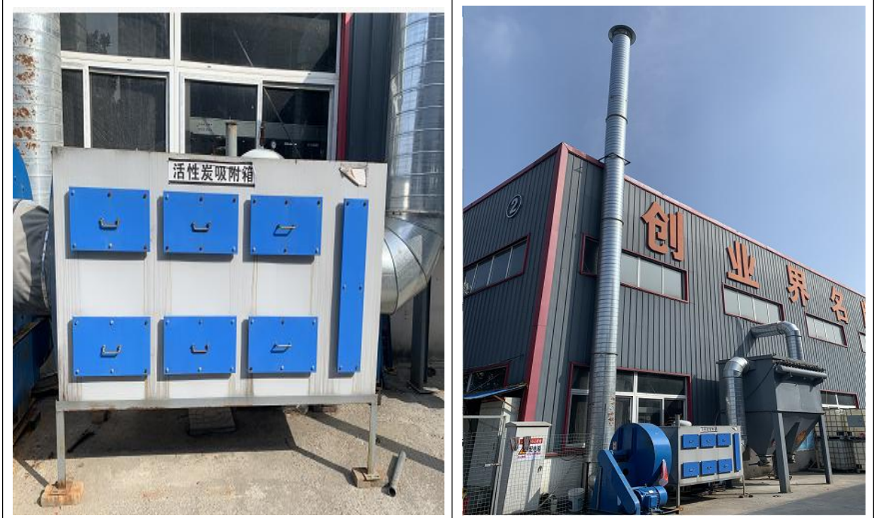
投料、研磨分散、调和调色、过滤、包装：布袋除尘器+二级活性炭吸附装置+15m 高排气筒（DA002）
