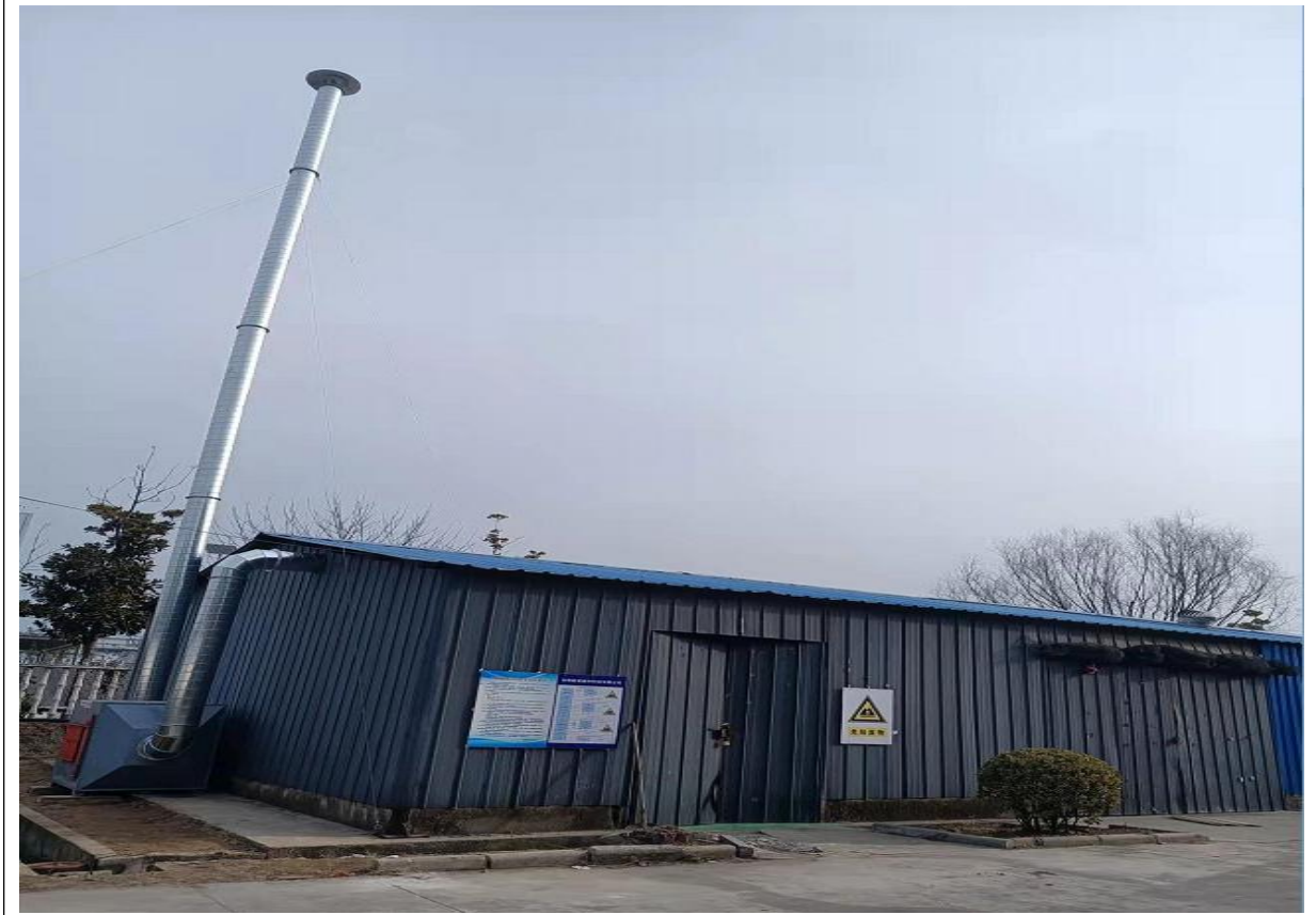
危废暂存间：二级活性炭吸附装置+8m 高排气筒（DA003）
