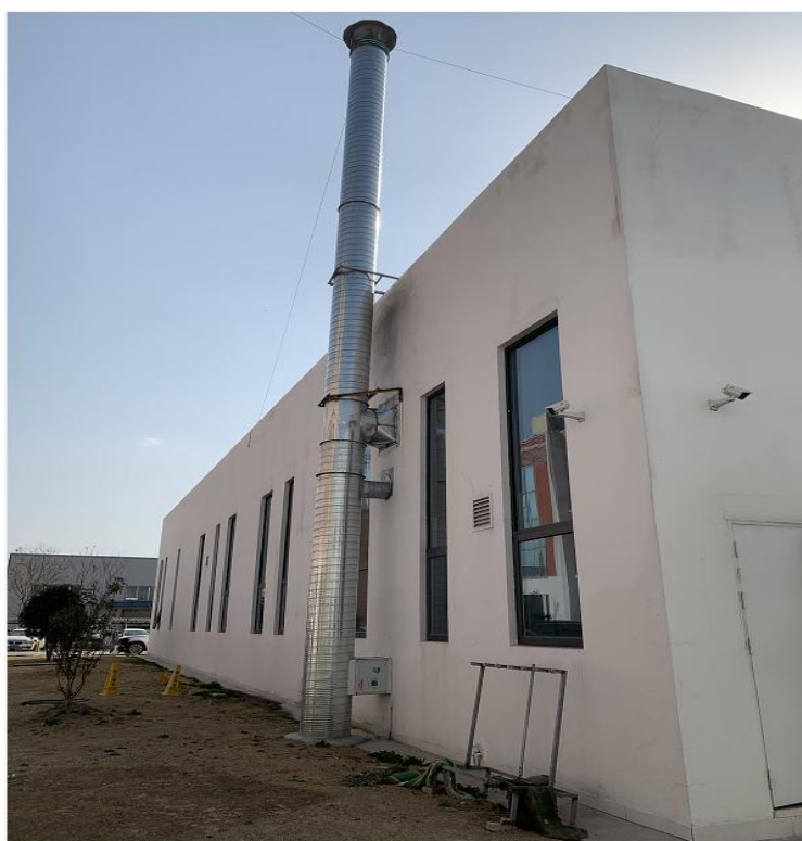
喷漆房：负压收集+过滤棉+二级活性炭吸附装置；调漆房：二级活性炭吸附装置；共用一根 15 米排气筒排放
