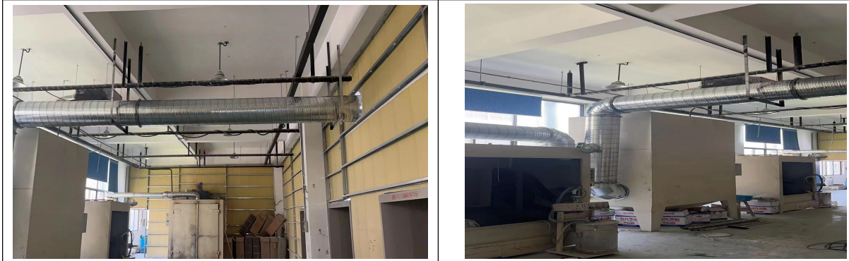
3 台喷塑柜集气管道
