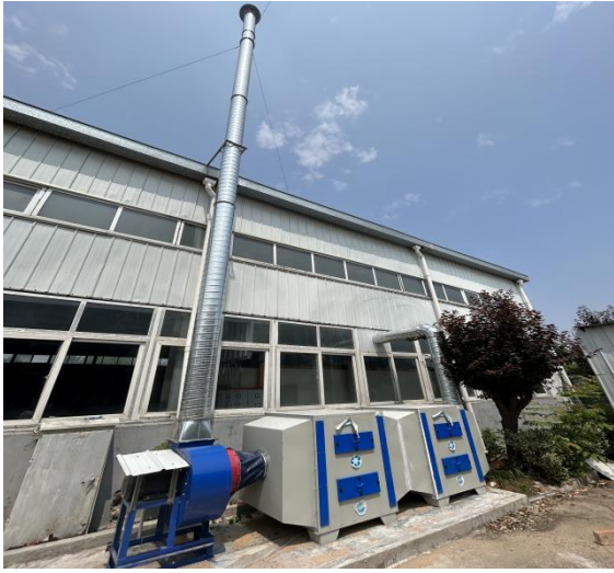
浸漆工序处理设施：二级活性炭+15m 排气筒
