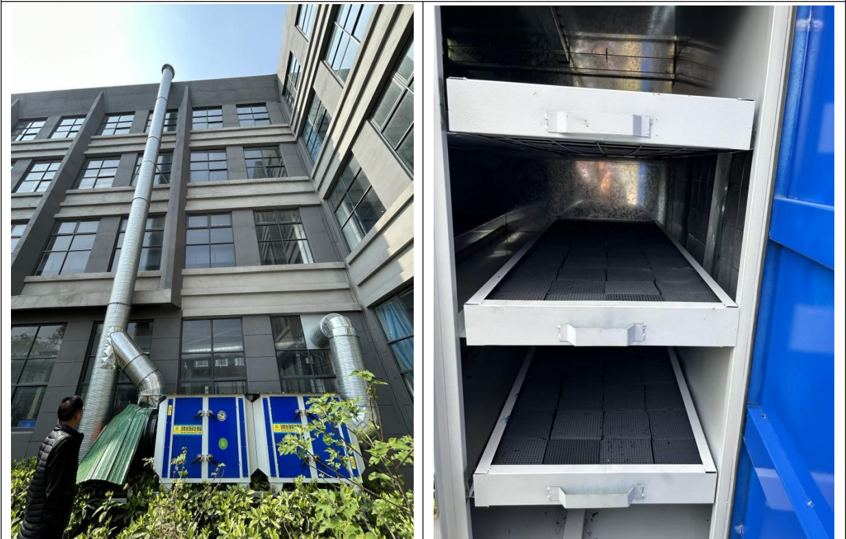
发泡废气处理设施
