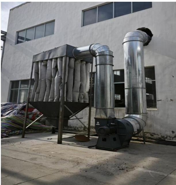
搅拌工序布袋除尘器
