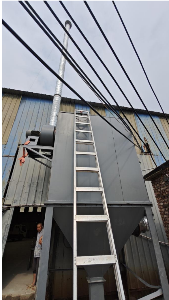
布袋除尘器+15m 排气筒
