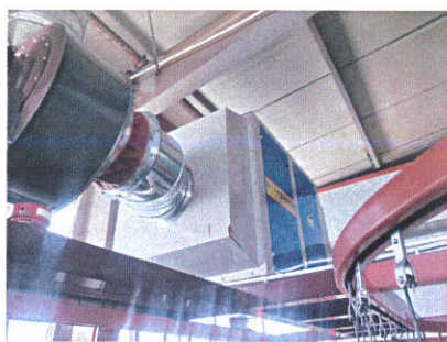
固废废气处理设施
