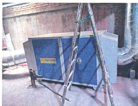
废气处理设施
