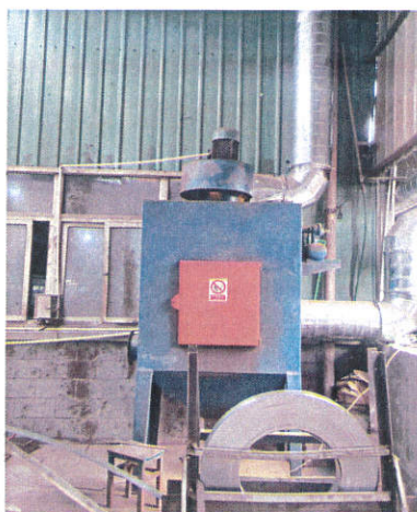
喷塑粉尘废气处理设施
