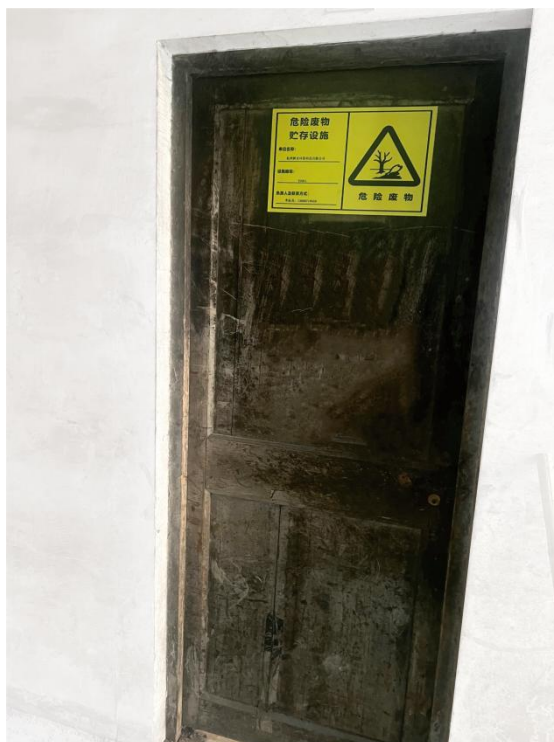
危险废物仓库现场照片
