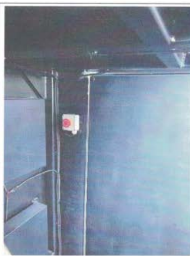
图 2 检修门右侧增设的急停按钮
