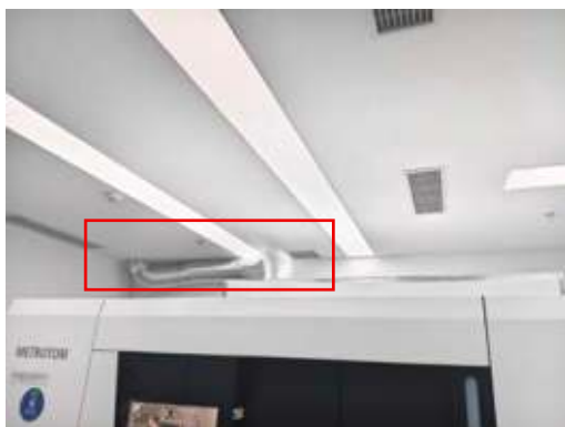
图 3-3.7 工业 CT 上方排风管道
