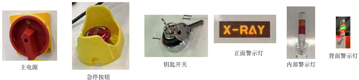
图 10-6 安全设施实物图
