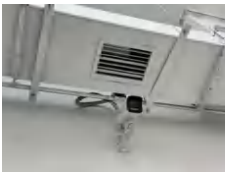
图 3-6 机械排风设施
