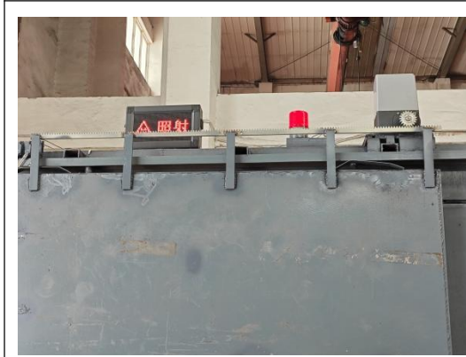
图 3-6 探伤室顶部“照射”指示灯
