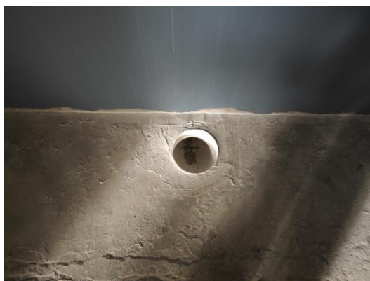
图 3-16 探伤室内通风口
