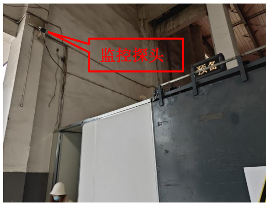
图 3-14 探伤室外出入口处监控探头
