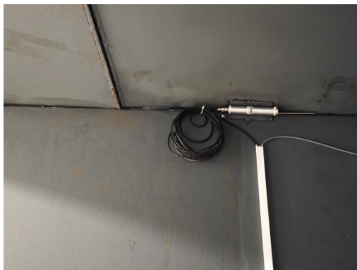
图 3-18 探伤室内固定式辐射监测探头
