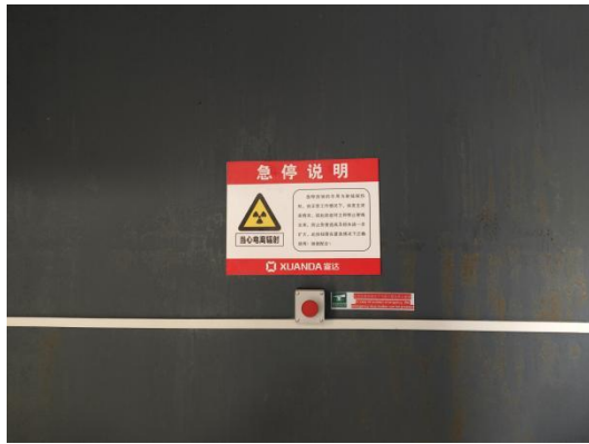
图 3-11 探伤室内急停按钮（含急停说明）
