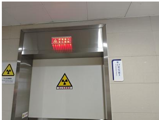
图 1 工作状态警示灯和电离辐射警告标志
