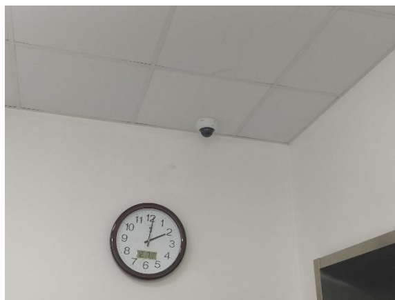
图 3-15 候诊室内监控探头
