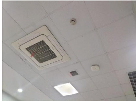
图 3-4 SPECT/CT 机房内通风装置
