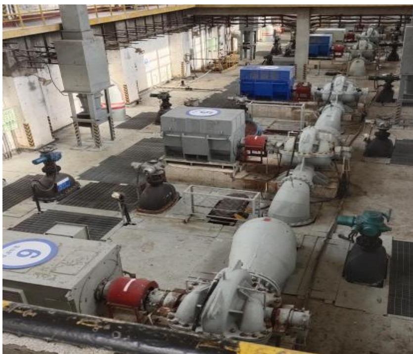
回水泵房照片
