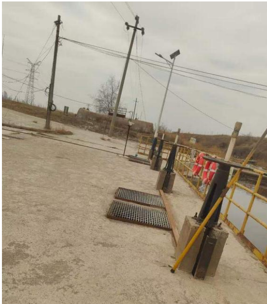
回水泵站用电线路
