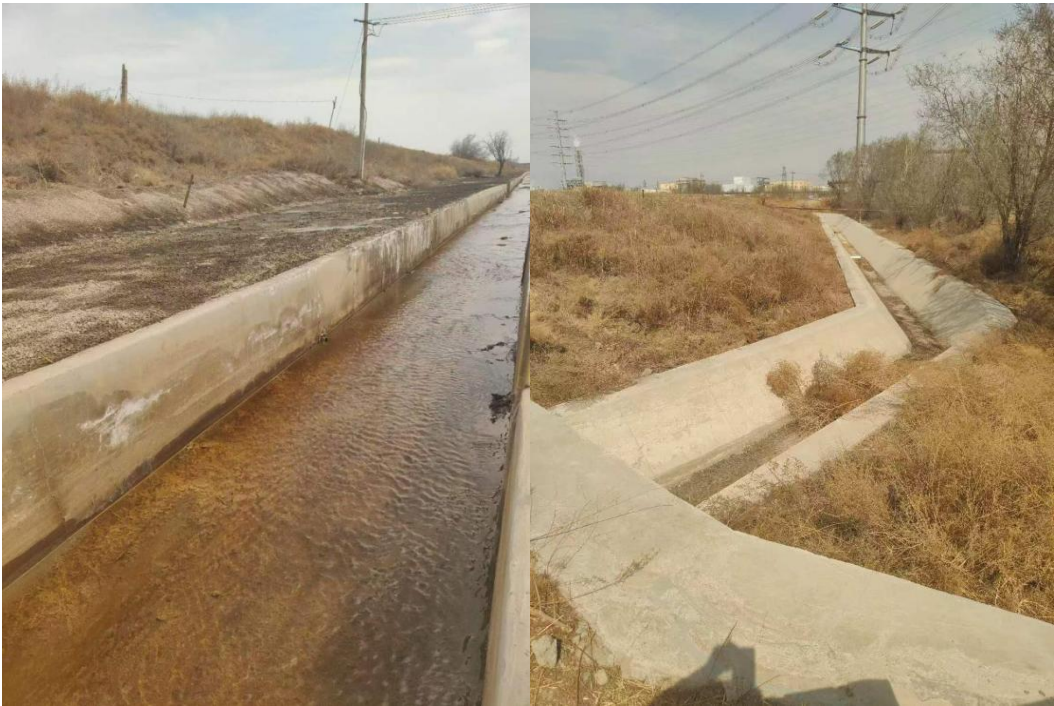
尾矿库排洪设施照片
