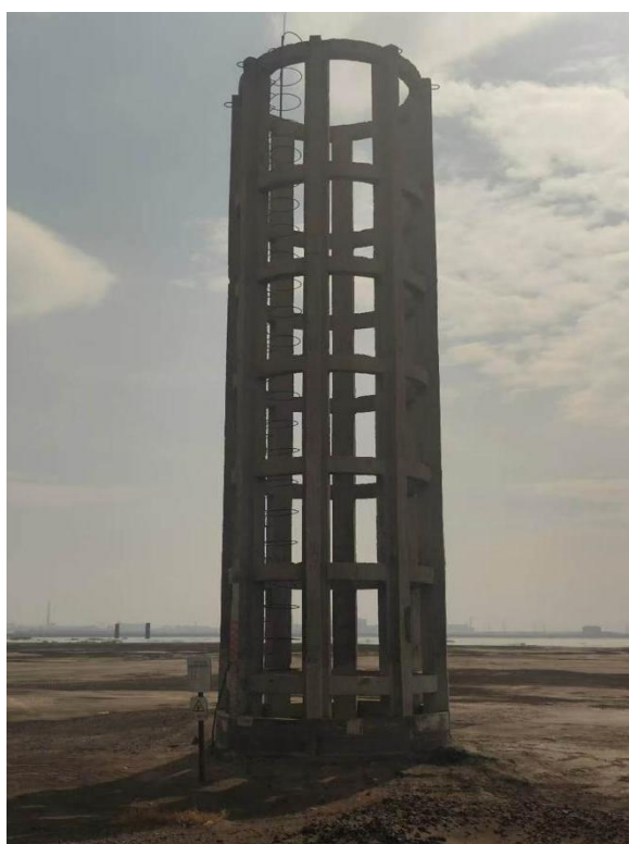
库内回水塔照片
