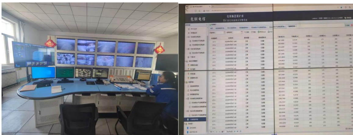
中控室及在线监测系统照片
