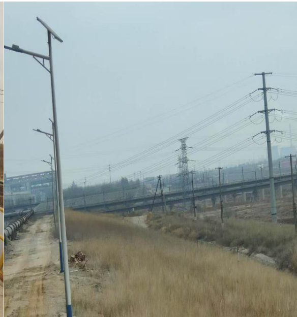
库区照明用电线路照片
