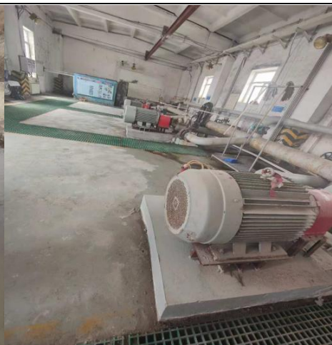
渗流泵站照片
