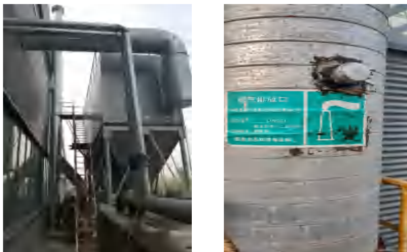
图 4 铝棒加热废气排放口DA001及其检测口
