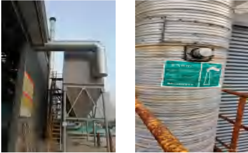
图 5 时效炉废气排放口DA002及其检测口
