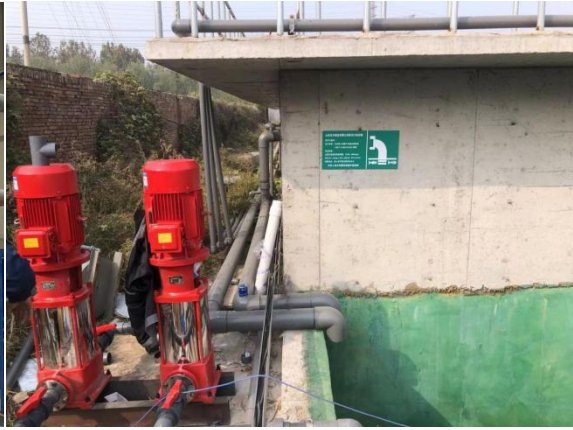
图 4 厂区污水处理站
