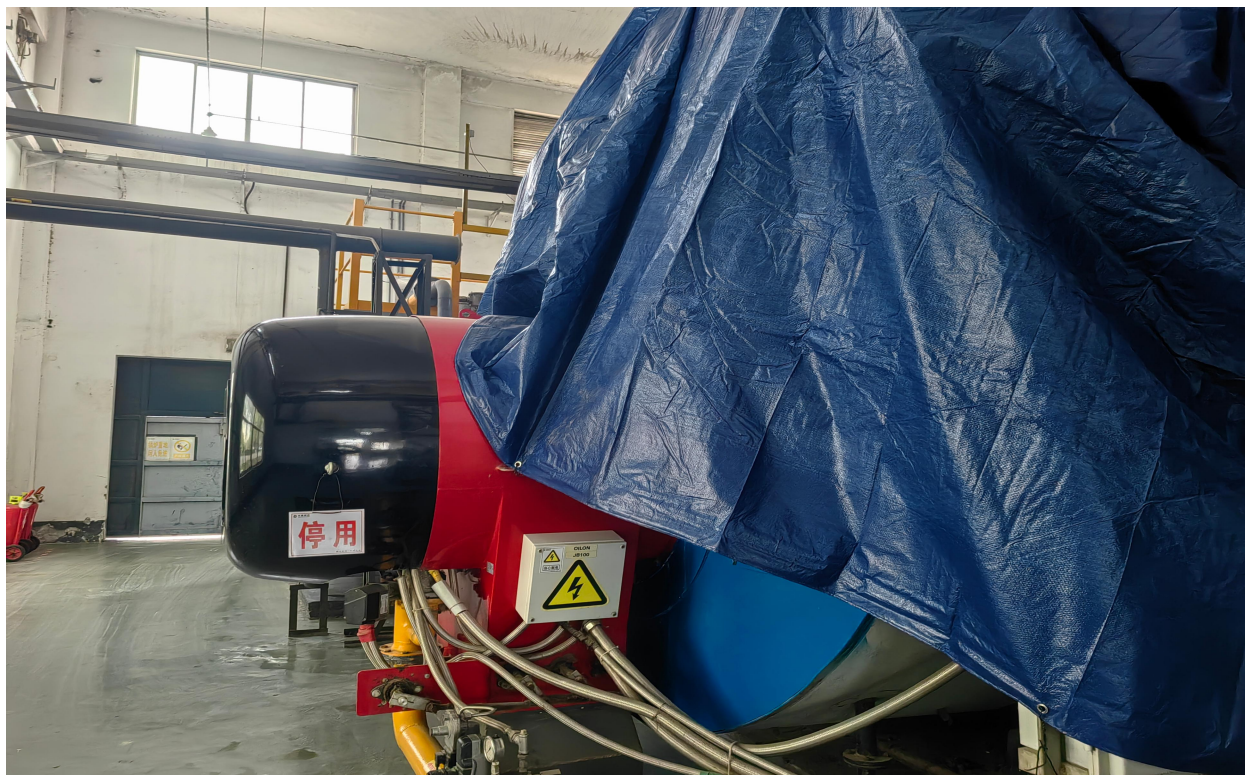
图10 原有1台20t/h 水冷预混超低氮燃气冷凝蒸汽锅炉已停用
