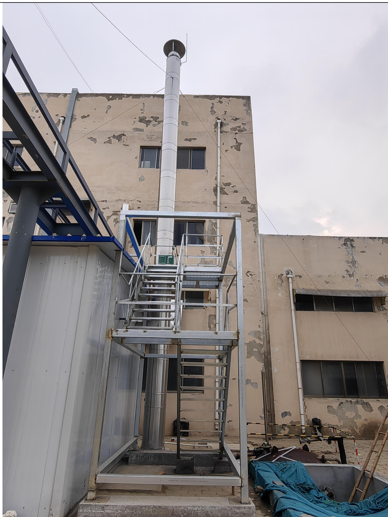
图6 （燃气蒸汽发生器废气排放口3#） DA013
