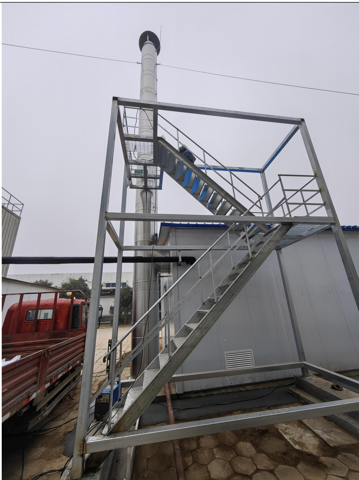
图5 （燃气蒸汽发生器废气排放口2#） DA012
