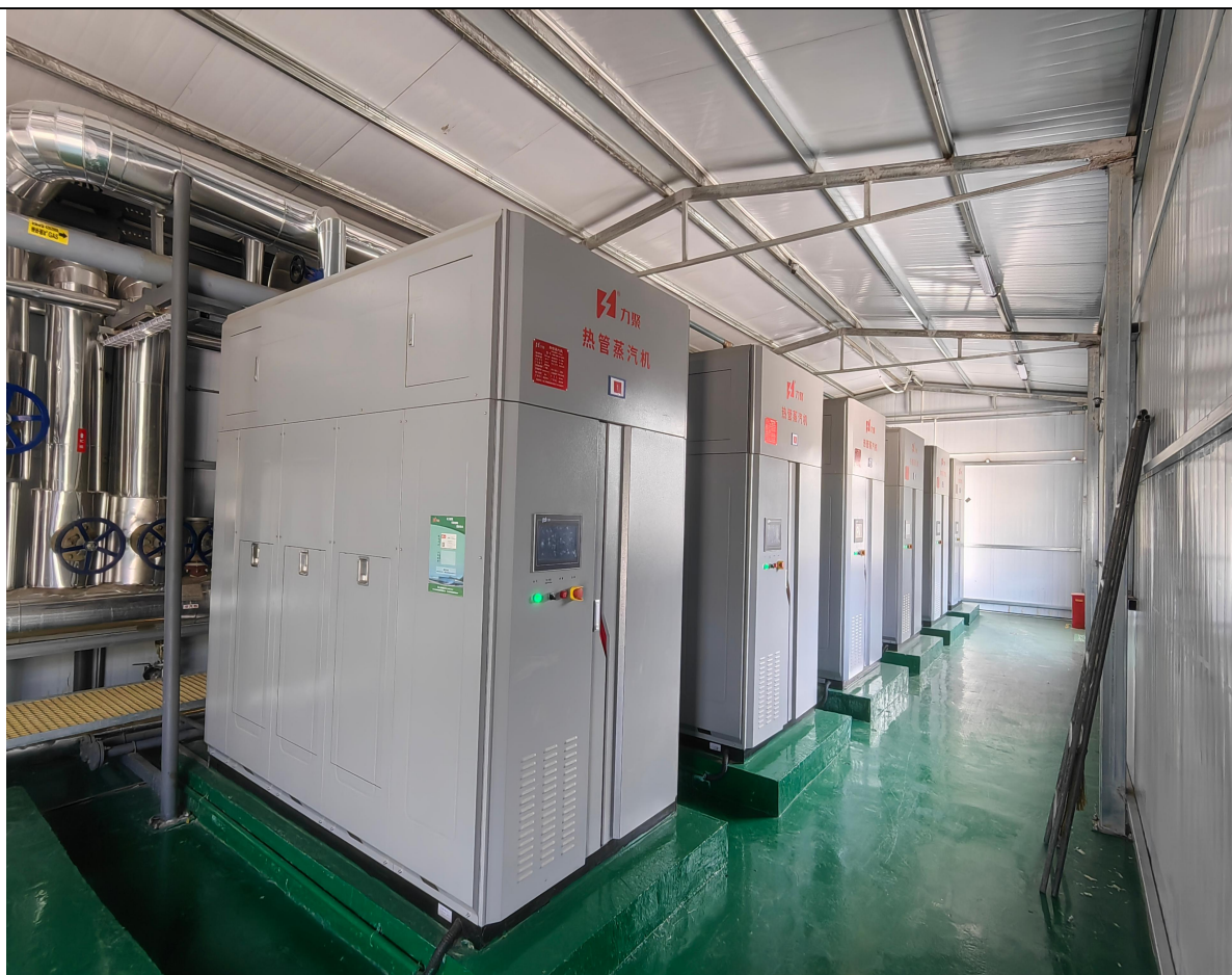
图 8 三生产区北侧燃气蒸汽发生器（6 台）
