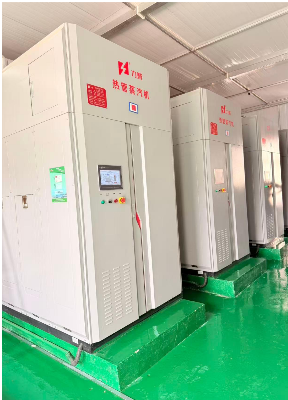
图 7 一生产区北侧燃气蒸汽发生器（4 台）
