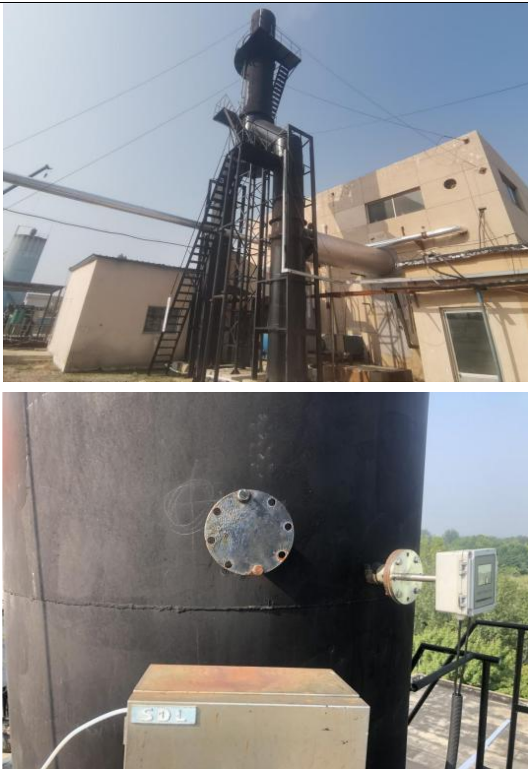
图 4（燃气锅炉废气排放口）DA004
