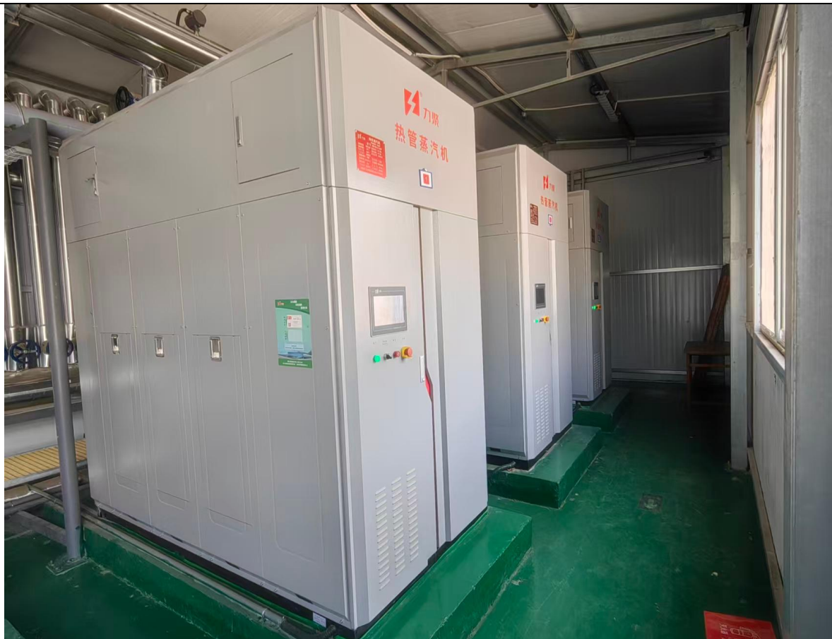
图9 四生产区原706泵房燃气蒸汽发生器(3台)
