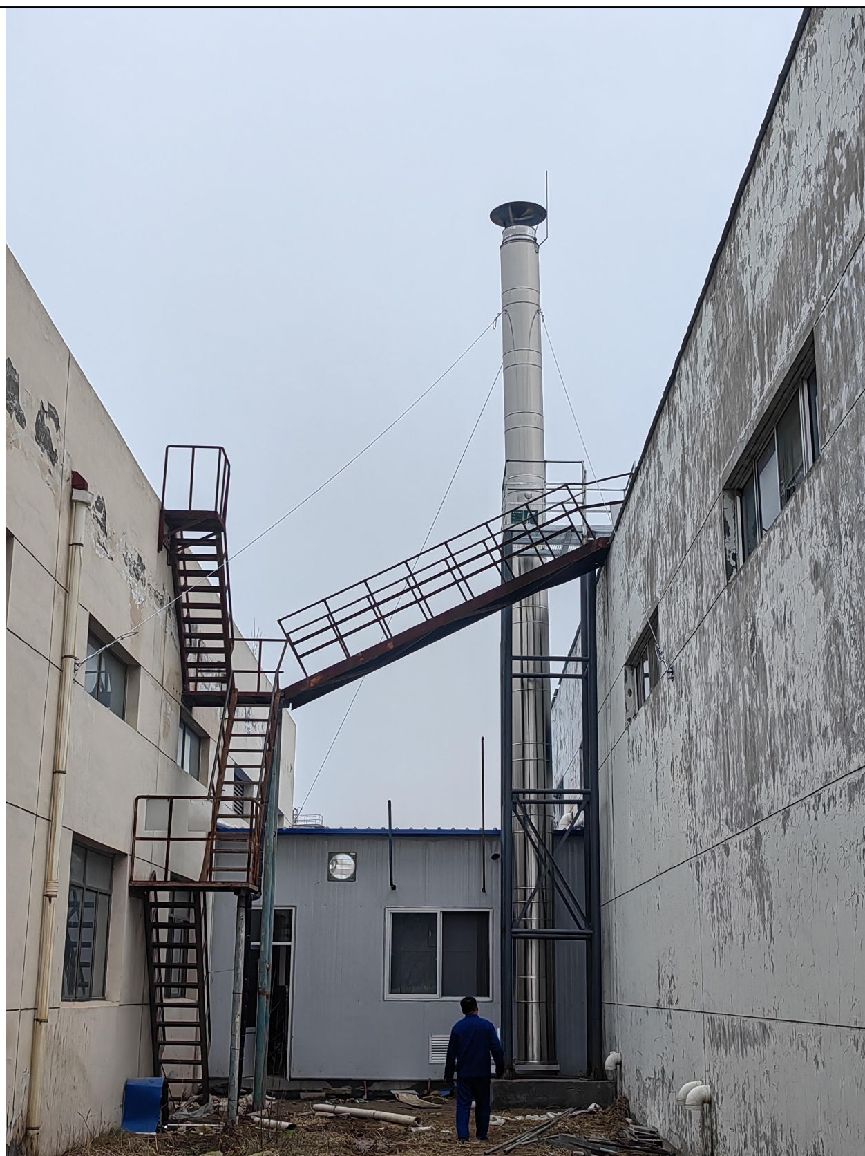
图3 （燃气蒸汽发生器废气排放口1#） DA001
