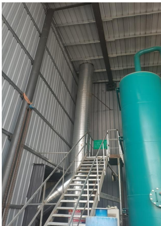
图 6 DA001 检测平台
