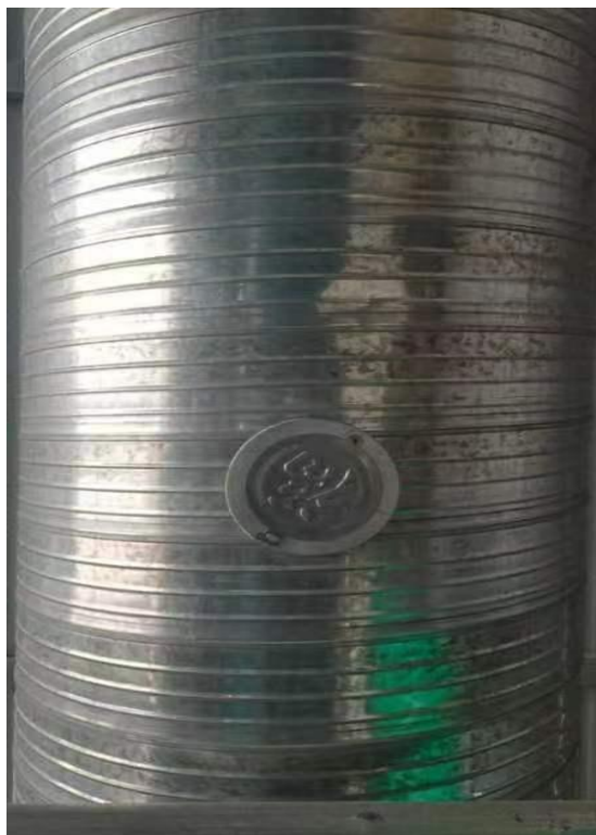
图9 排气筒DA001检测孔
