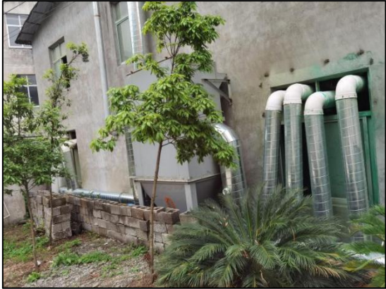
处理设施（布袋除尘器）
