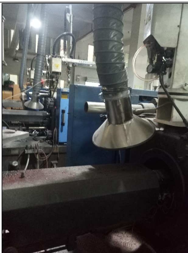
废气收集管道
