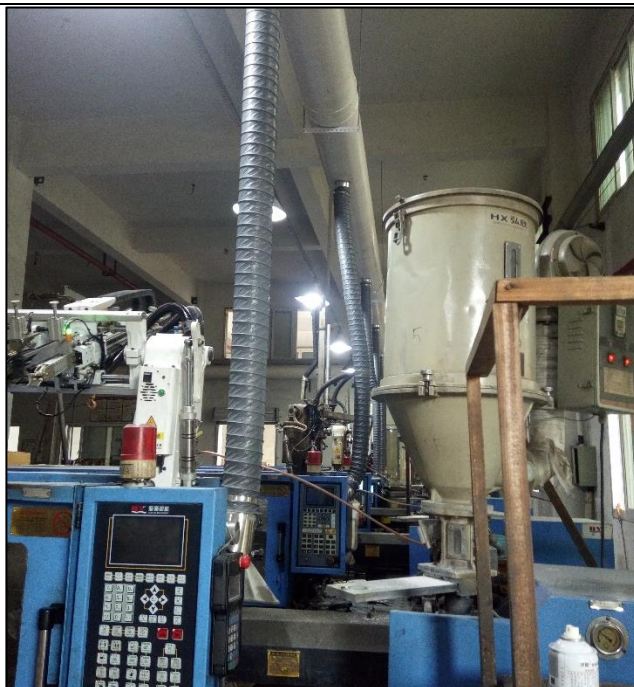
废气收集管道
