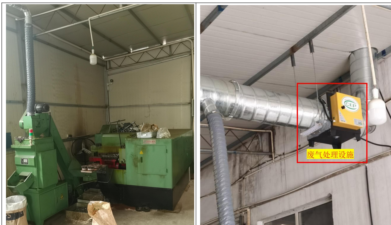
废气收集处理设施
