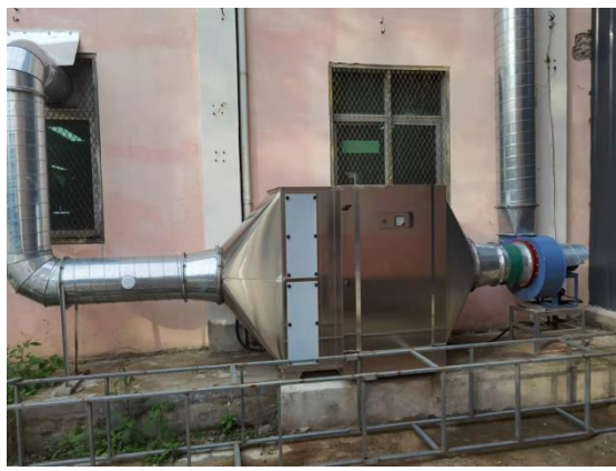
废气治理设施（光催化氧化设备）
