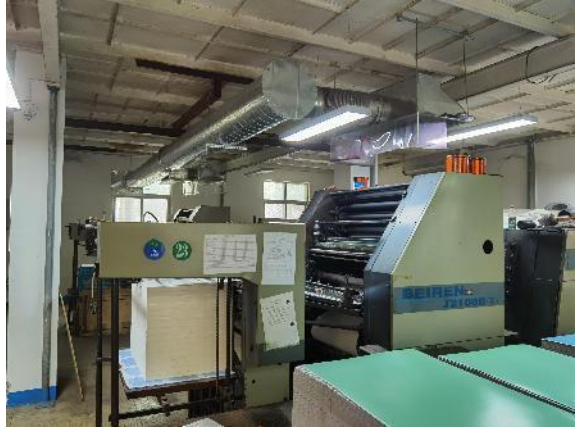
废气收集管道
