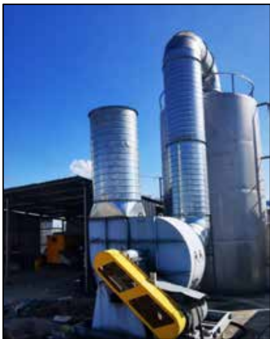
废气治理设施（水喷淋塔）
