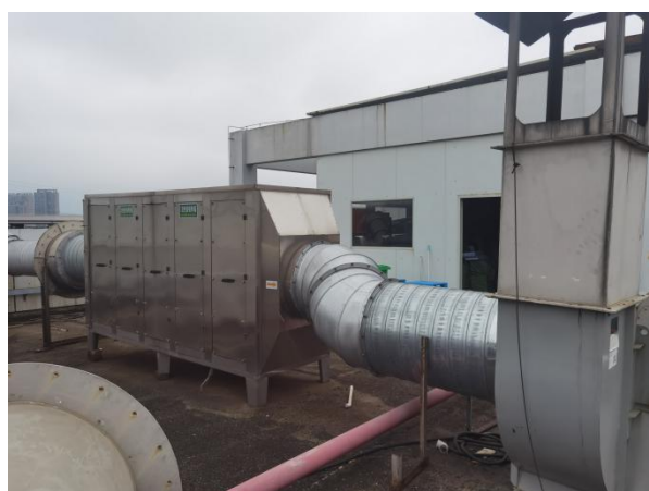
移印、镭雕废气治理设施
