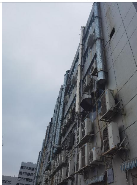
锡焊、注塑、涂覆固化废气收集管道
