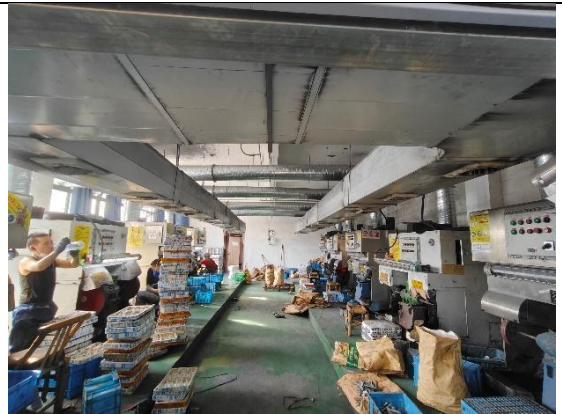
废气收集处理设施（水膜除尘）
