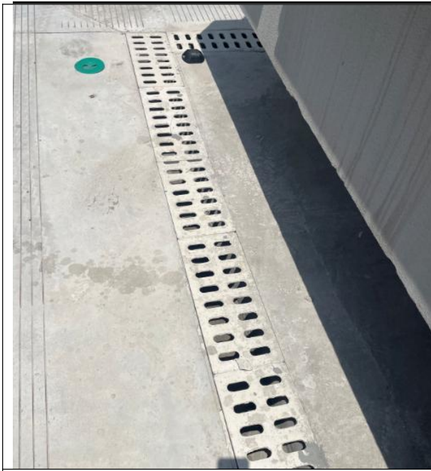
排水明沟（导流沟）
